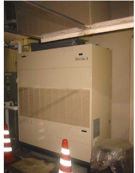
代替冷媒使用空調機(小山工場)
