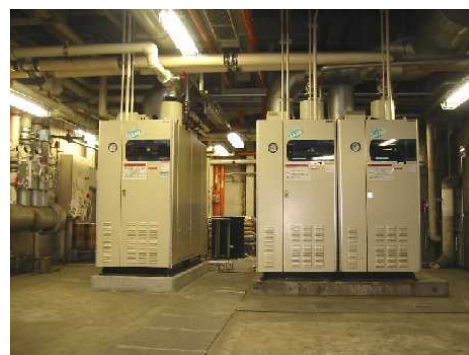
都市ガス燃料ボイラー(小山工場)
