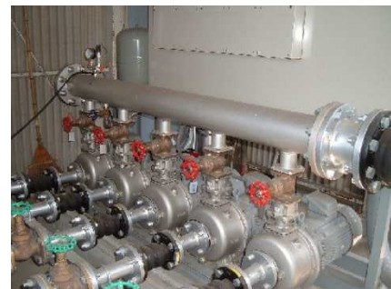
給水ポンプ台数制御(鶴見工場)
